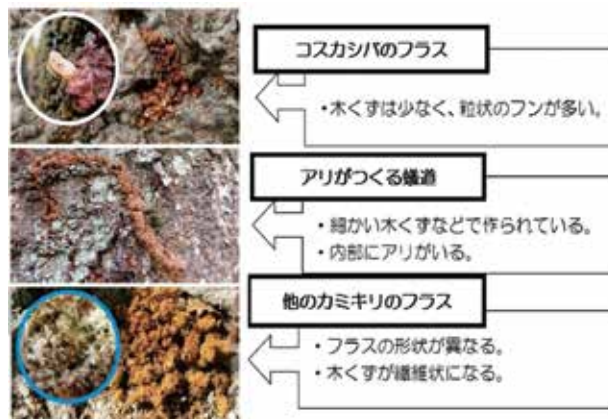
図4 間違いやすいフラス・被害
